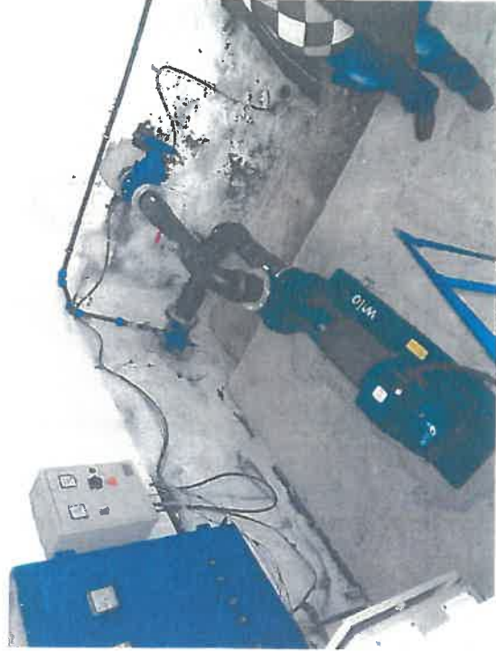
Foto 16: Vedere interioara casa pompe cheson captare.
