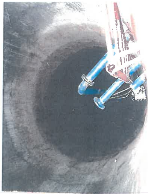
Foto 17: Interior cheson de captare.
