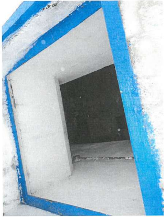
Foto 9: Puț de captare zona „captarea noua”-vedere interioara.
